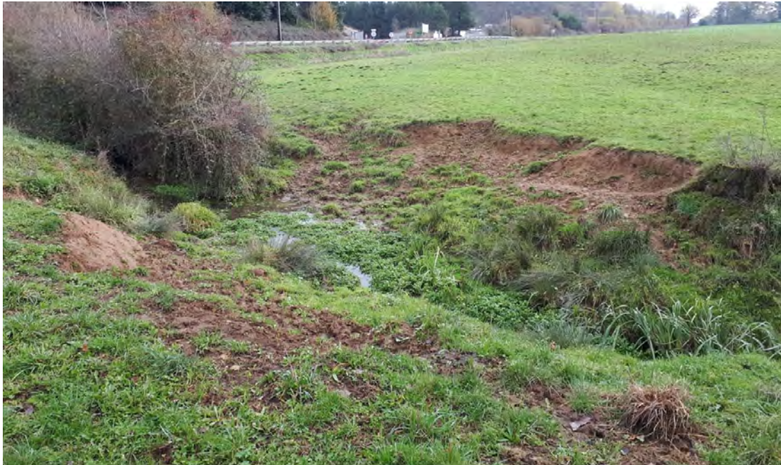
Figure 15 - Etat initial : zone de traversée et d'abreuvement du bétail sur le ru de Laurier Le ru de Laurier rejoint le ruisseau de Roche à 80 m au Sud de la RD 86.
